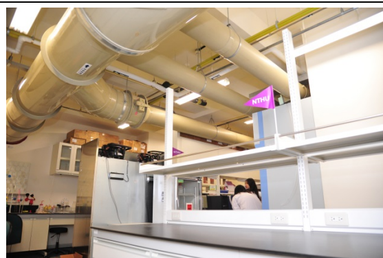
清華實驗室統一建置廢氣排放管線
