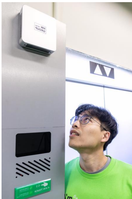
m'AI Touch 裝設於電梯按鍵面板上方近天花板處
